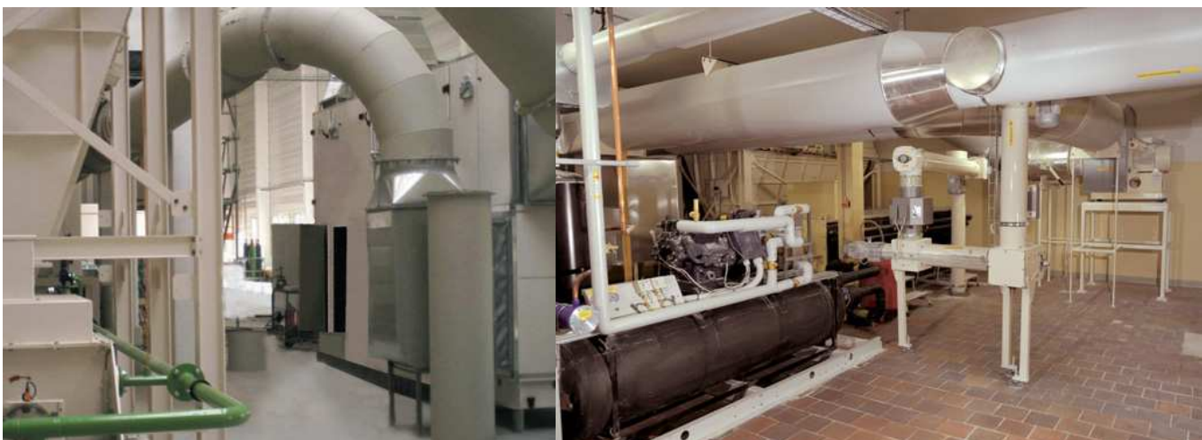
Unidad de climatización de aire
